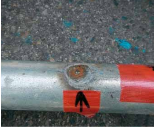
A-9 ① 切断、亀裂、穴開き等の破損
