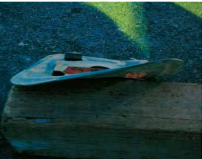
全体の曲がり、変形
