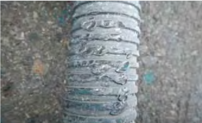
ネジ管部分のへこみ
