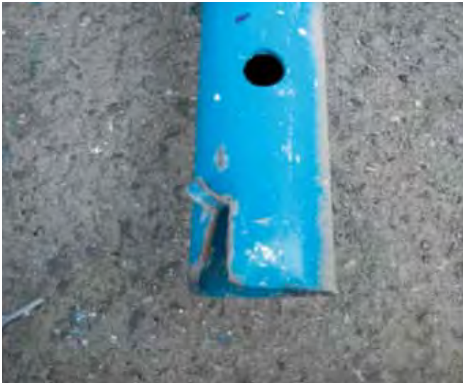
A-5 ② 切断、亀裂、穴開き等の破損
