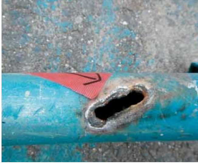
A-9 ② 切断、亀裂、穴開き等の破損
