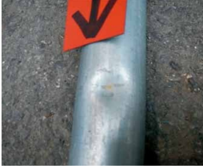
A-7 ① 打ち込み部分以外のへこみ
